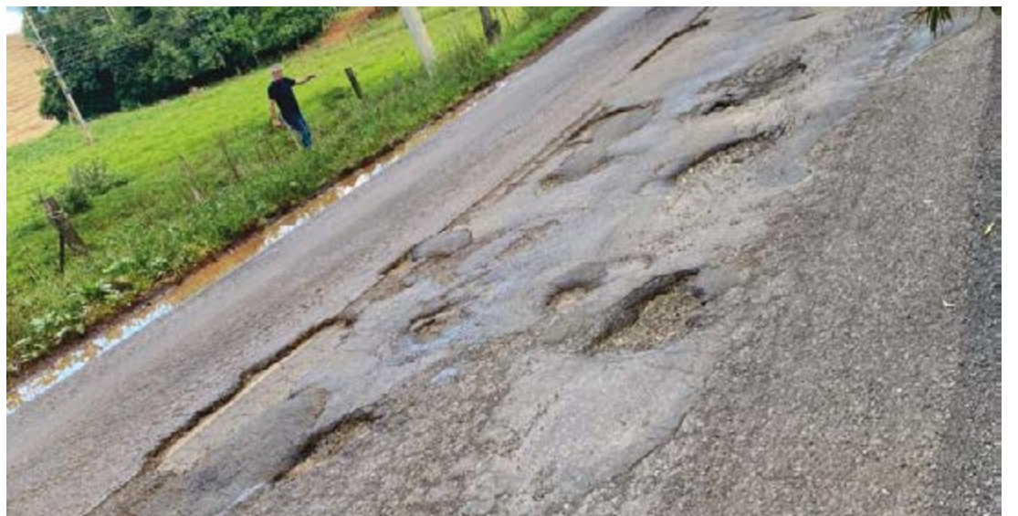
ERS-463, entre Tapejara e Coxilha, e a perimetral estão em condições críticas
