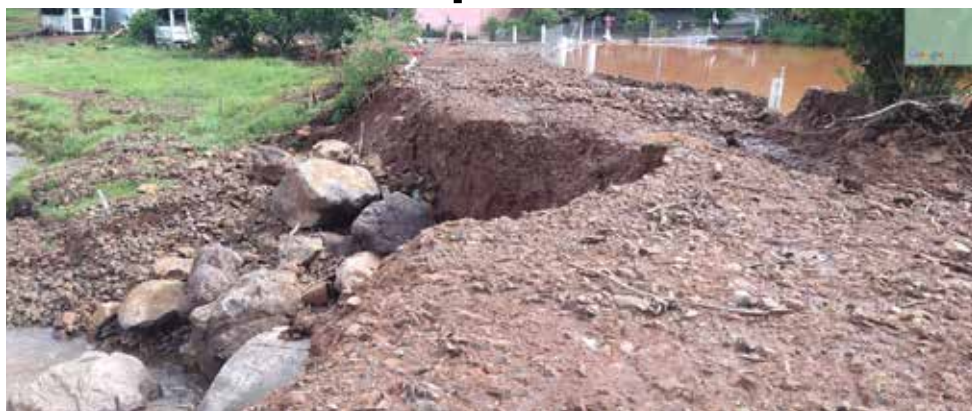
Estradas foram danificadas
