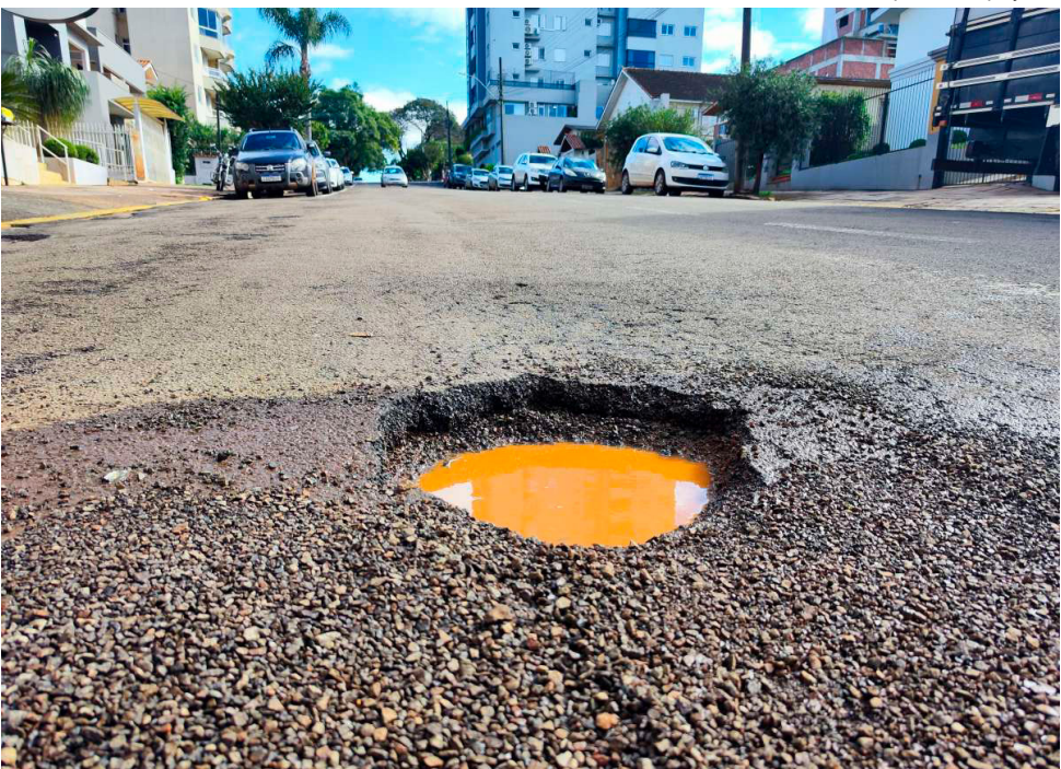
As avarias foram causadas pelas chuvas dos últimos dias, que abriram buracos no pavimento
