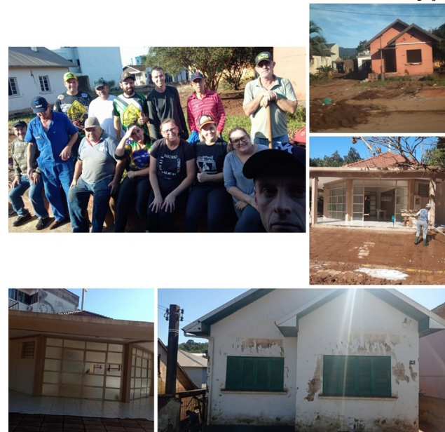
Os esforços concentraram-se especialmente na capela mortuária da cidade e em duas residências que haviam sido completamente tomadas por lama e barro
