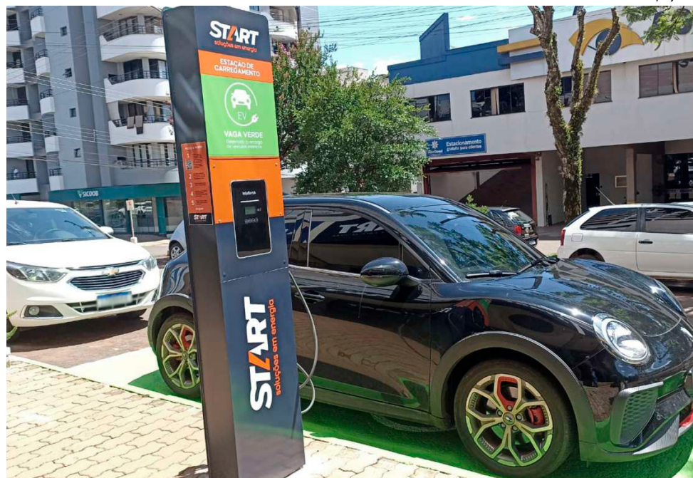
A estação foi desenvolvida e instalada pela Start Soluções em Energia
