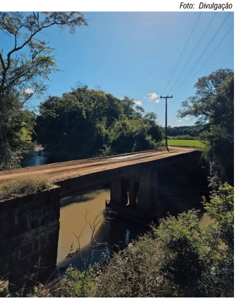
Ponte necessita melhorias
