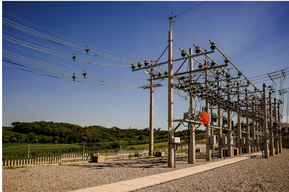
Nos últimos cinco anos, o município recebeu mais de R$ 37 milhões em melhorias no sistema elétrico
